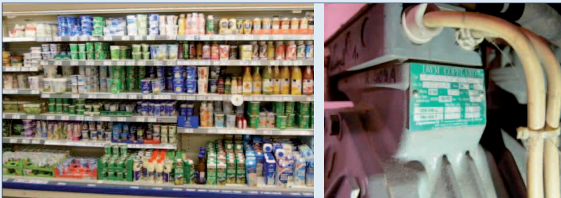
Abbildung 5. Kühlregal „Aindling I“ mit Einzelanlage aus 1979
