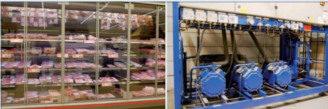
Abbildung 12. Fleischregal mit Verbundanlage
