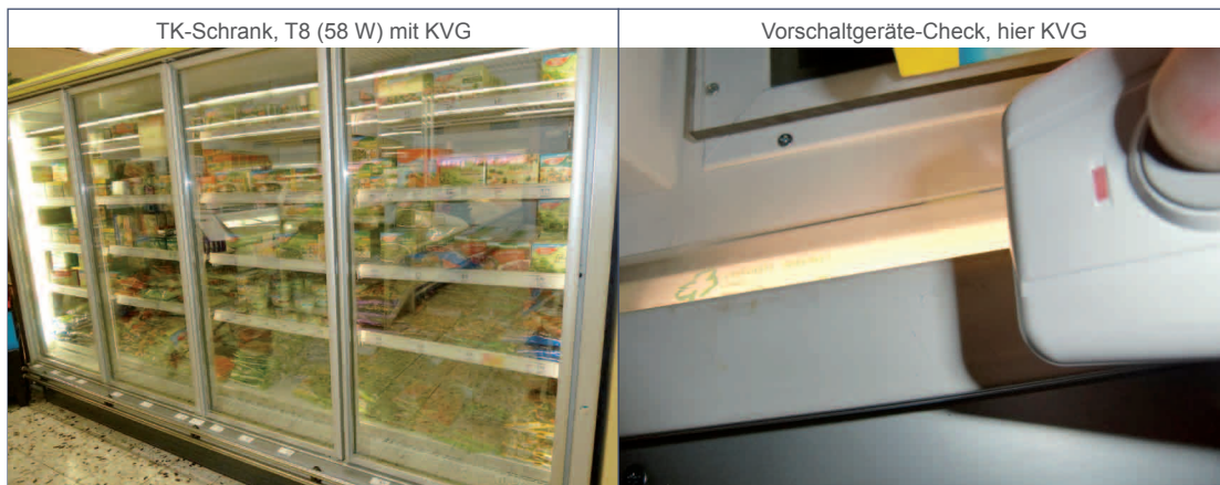
Abbildung 42. TK-Schrank mit T8-Leuchtstoffröhre (58 W) und KVG
