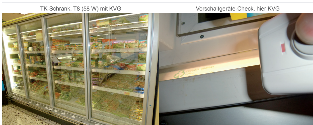
Abbildung 42. TK-Schrank mit T8-Leuchtstoffröhre (58 W) und KVG
