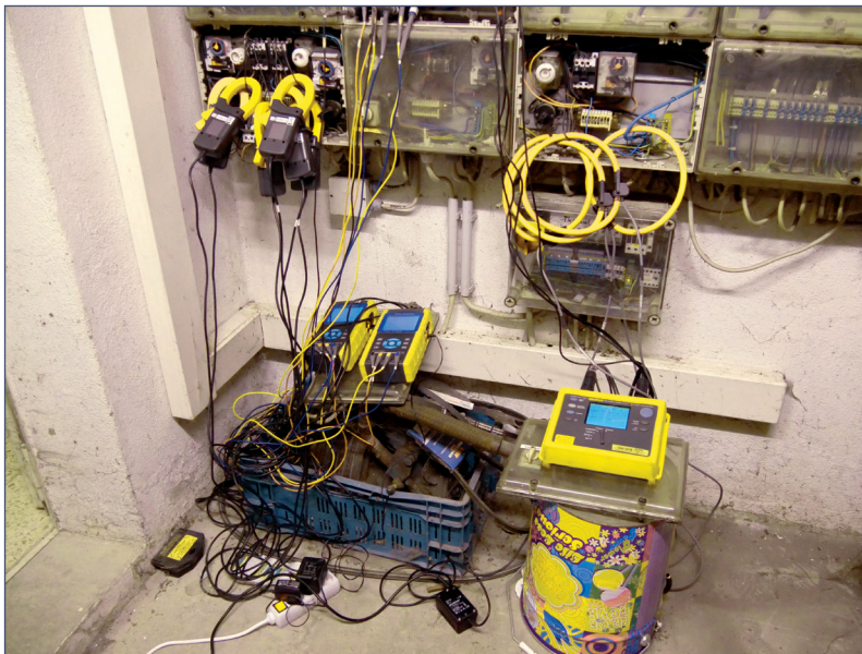
Abbildung 13. Typischer Messaufbau in älteren Unterverteilungen 16
