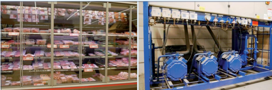
Abbildung 12. Fleischregal mit Verbundanlage
