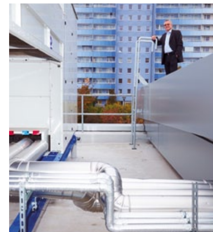
Heizen, Lüften und Kühlen mit einer zentralen Kälteanlage, LIDL-Filiale in Weißwasser (vgl. Seite 19)
