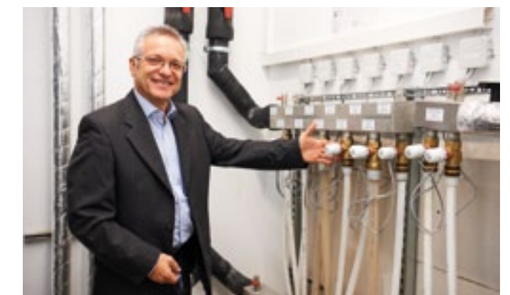
Jens Köhler am Verteiler für die effiziente Fußbodenheizung
