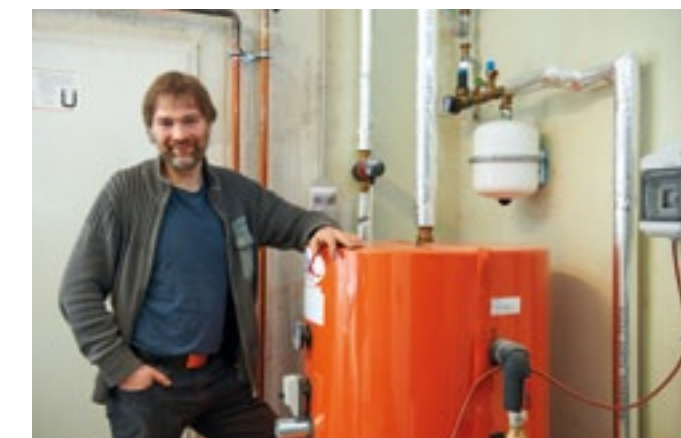
Ein Wärmespeicher gehört zum System der Wärmerückgewinnung.
