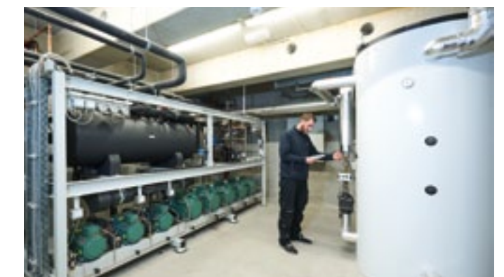
Kühlaggregate und Pufferspeicher für die Abwärme
