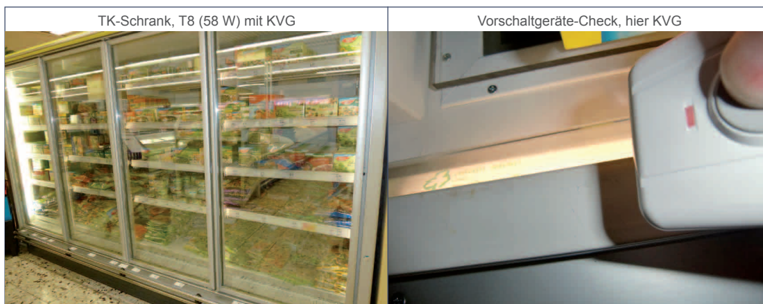
Abbildung 42. TK-Schrank mit T8-Leuchtstoffröhre (58 W) und KVG
