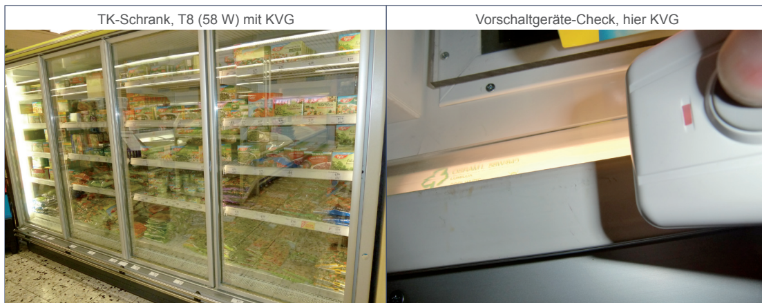
Abbildung 42. TK-Schrank mit T8-Leuchtstoffröhre (58 W) und KVG
